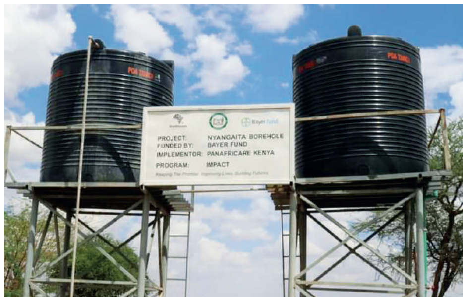
Les réservoirs d'eau du forage de Nyangaita assurent un approvisionnement ininterrompu (Ph. Sammy Lutta)
